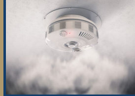
انظمة سحب الدخان Smoke Control System
